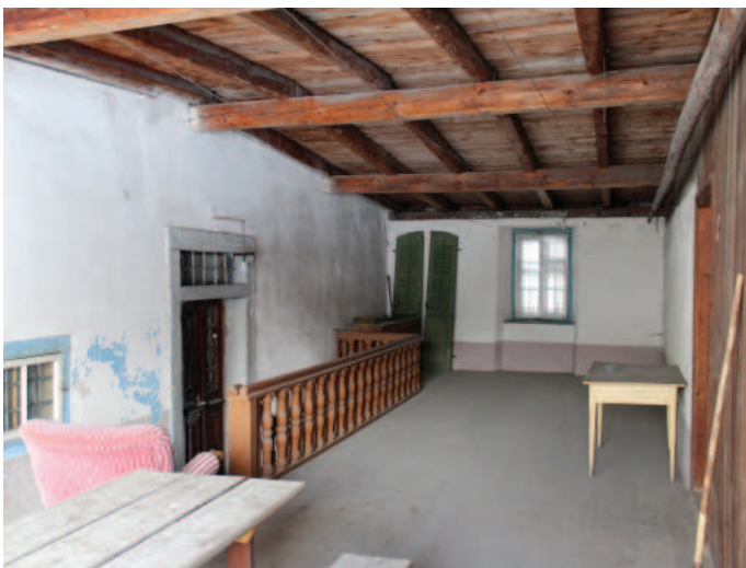
In die Durchfahrt eingezogener Boden als Verbindungsfläche vom ersten Obergeschoss zur Scheune. Foto DPG 2016
