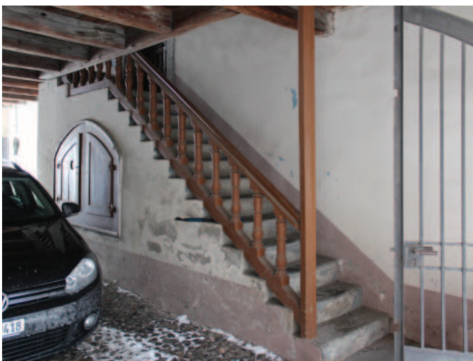
Treppenaufgang ins erste Oberschoss in der Durchfahrt zum Hof. Grosser Wandschrank innerhalb des Treppenkonstruktion. Katzenkopfpflasterung. Foto DPG 2016
