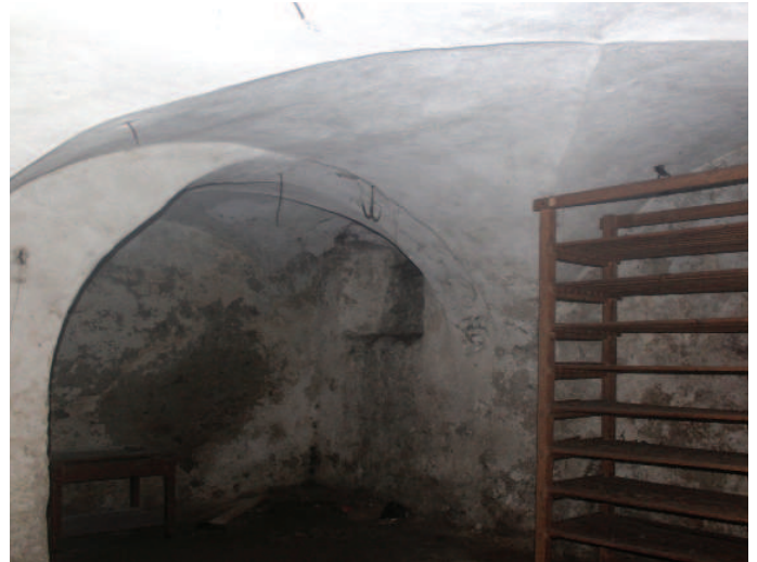
Kellerraum mit Kreuzratgewölbe im Südosten und Blick in den ebenfalls gewölbten Korridor. Foto DPG 2016
