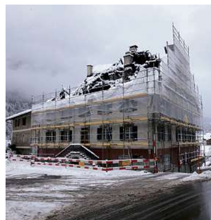
Gesichert: So präsentiert sich die Casa Carigiet diesen Winter mit dem Schutzgerüst für Passanten.
