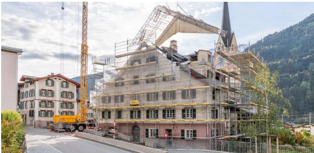
Aktueller Zustand der Casa Carigiet (2021, Errichtung des Notdaches)
